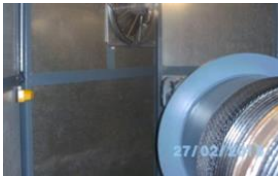
Abbildung 23: Absorbierende Innenauskleidung des Windeshauses (Quelle: Peutz Consult)
